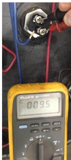
Figure 14. Vérification de la résistance de l'élément à l'aide d'un multimètre
